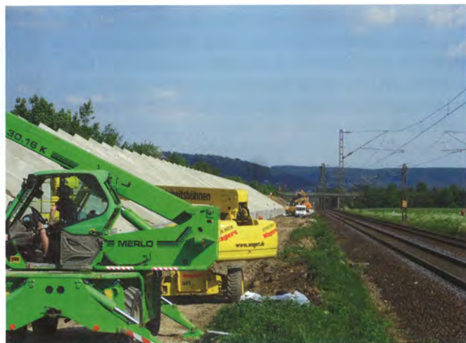
Die Solaranlage auf dem Lärmschutzwall wird über 744 Meter lang.
